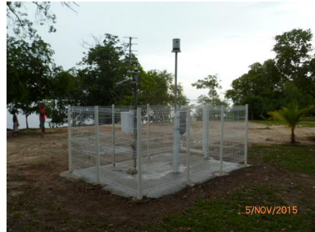
Estação telemétrica PCD VAISALA GOES em Barcelos/AM (com sensor de pressão)
